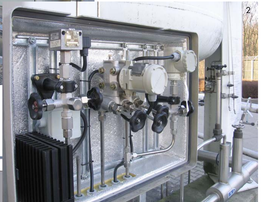
Abb. 2: Messwandlerkasten vor Ort mit Frostwächter
