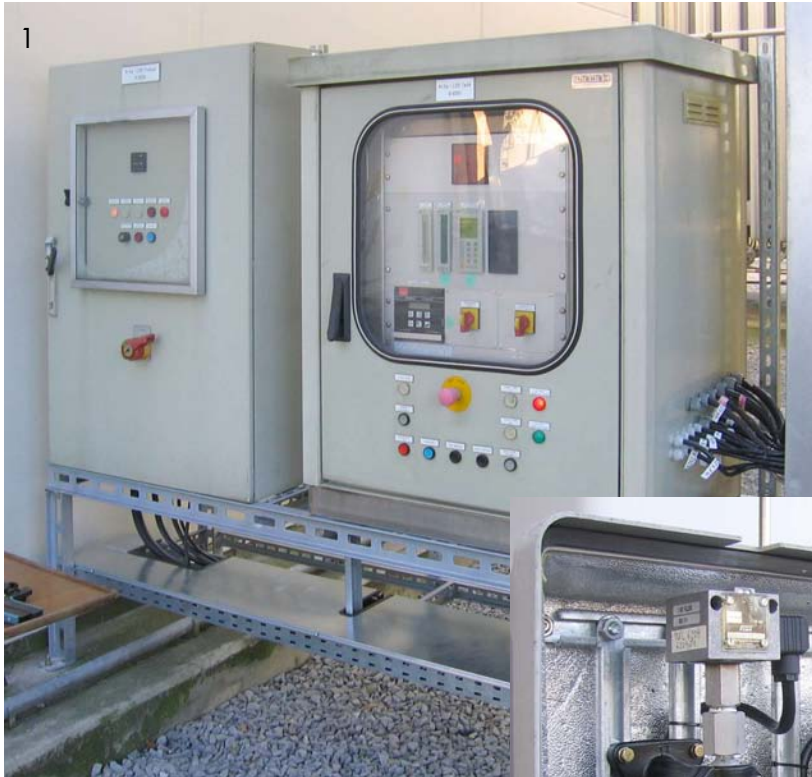
Abb. 1: Mess- und Regelschaltschränke
