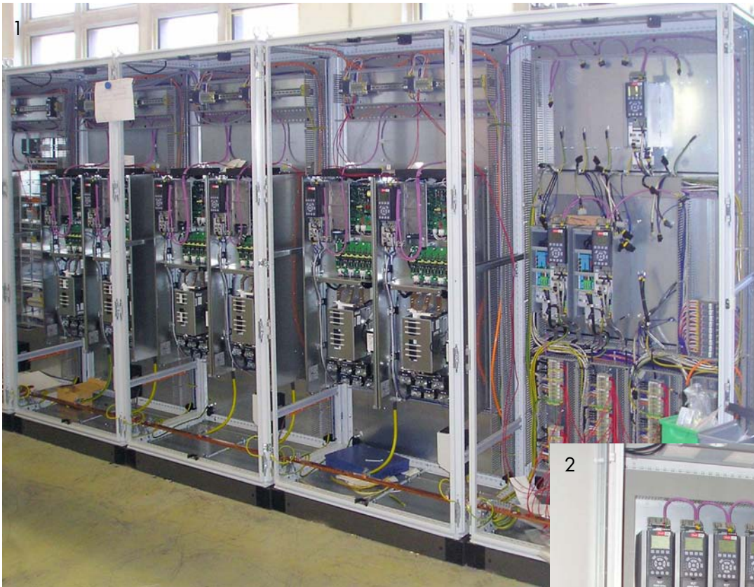
Abb. 1: Teilansicht von Schaltschränken mit 45 Danfoss-Frequenzumrichtern
