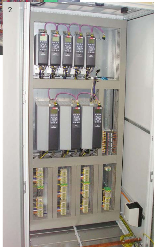
Abb. 2: Detailansicht mit 3- 7,5 kW Danfoss-Frequenzumrichtern
