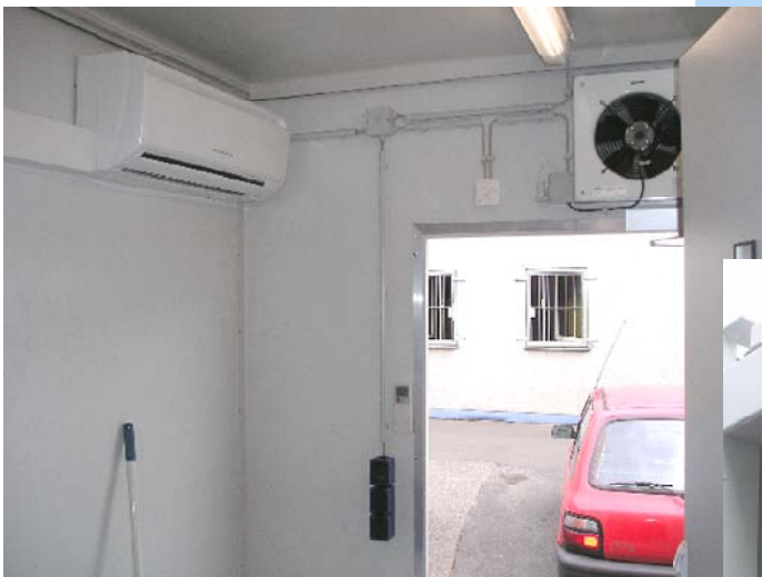
Abb. 3 Klimagerät im Innenbereich
